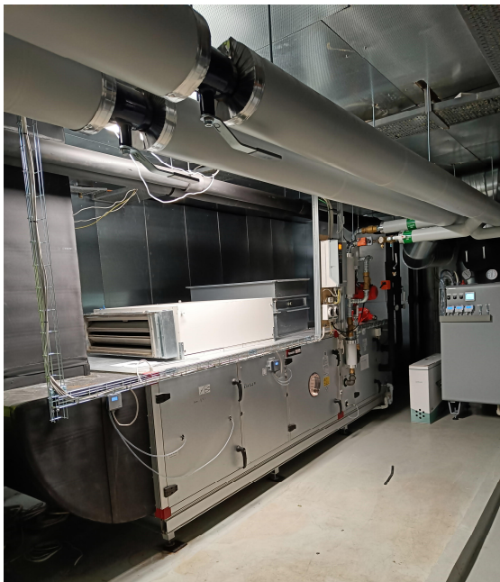
Kuva 8. B2-siiven uusittu tuloilmakone
